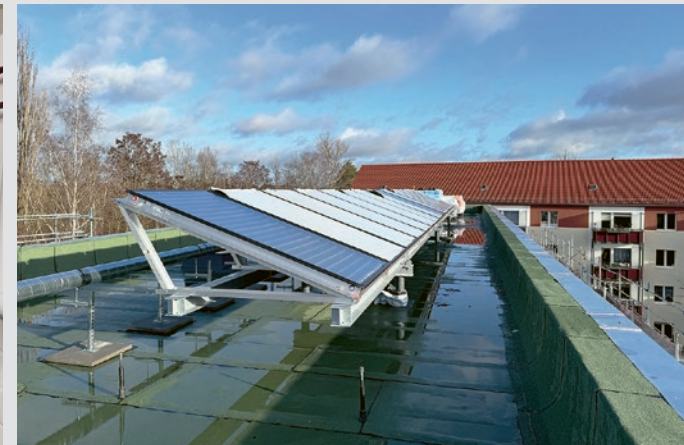
Lessingstraße 54 d, 54 e, Solarthermieanlage, August
