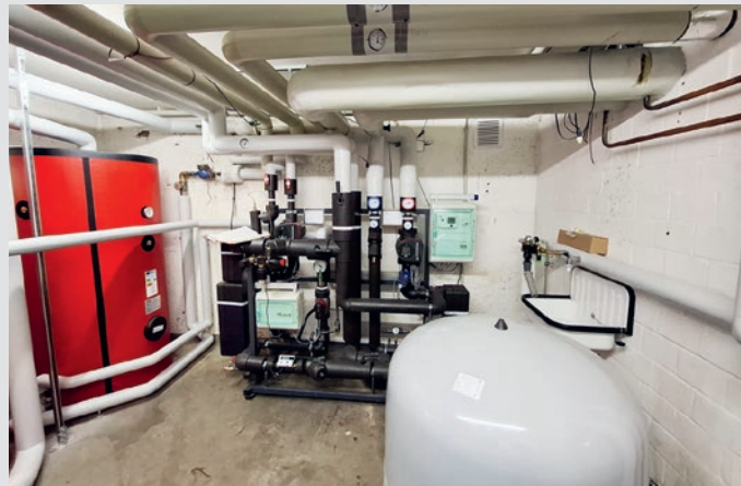
Klothildestraße 26 a - 28 b, Fernwärmeübergabestation
